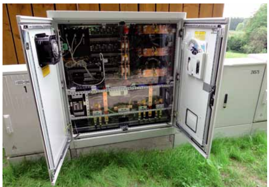
Bild 1. Die Thyrobox VR ist kaum größer als ein regulärer Kabelverteilschrank.
